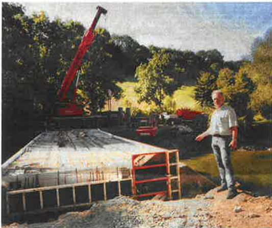
Die Brücke über die Diemel in Dalheim musste erneuert werden, weil sie für den öffentlichen Verkehr geschlossen werden sollte.
